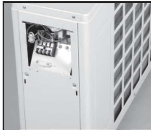
Raccords électriques du GC au ST
