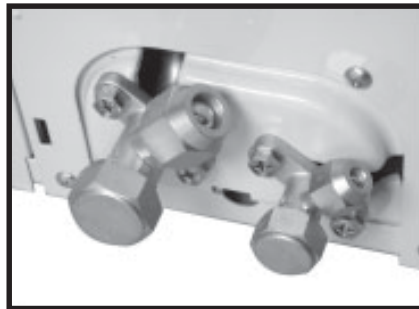
Raccords frigorifiques du GC au ST
